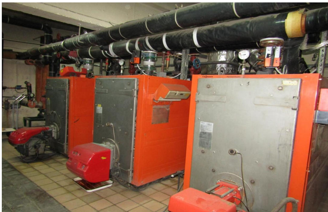
fot. 3 prezentacja zestawu kotłów grzewczych co i cwu z systemem zasileń i powrotów obiegu instalacji ciepłowniczej
