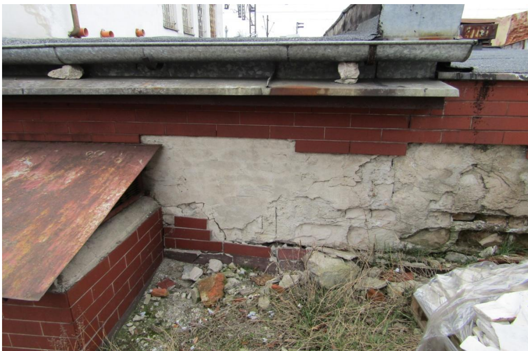
fot. 1 fragment części naziemnej budynku z widocznymi ubytkami powstałymi w wyniku wilgoci przenikającej ściany z gruntu do wewnątrz – brak izolacji pionowej i poziomej
