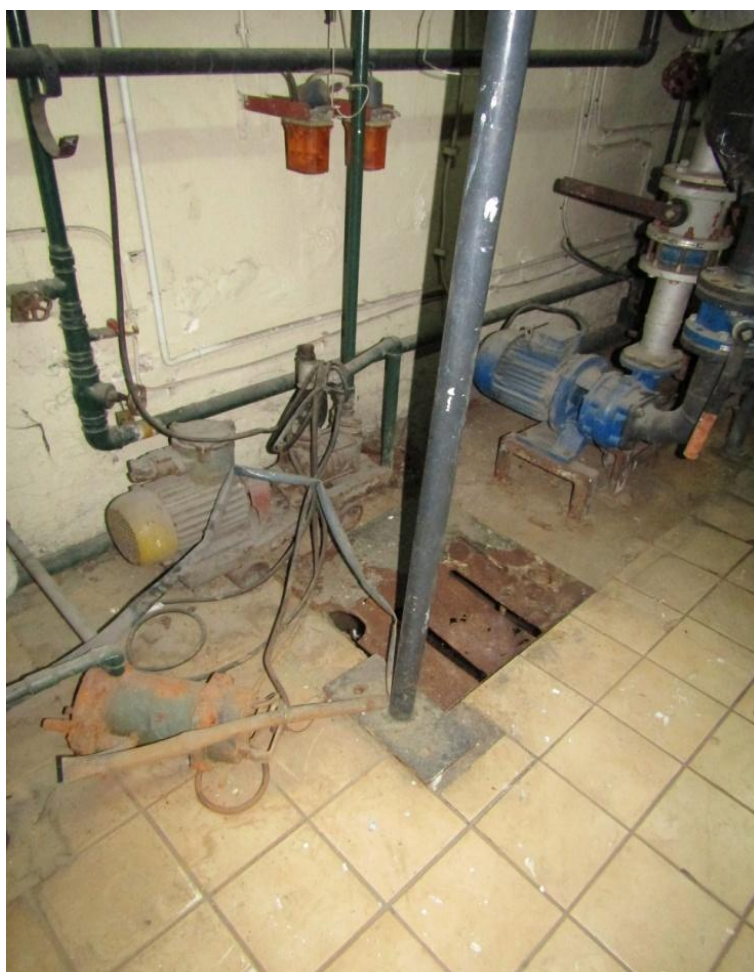
fot. 6 pompa i studzienka odwadniająca odprowadzająca wody z systemów ciepłowniczych i grzewczych kotłowni
