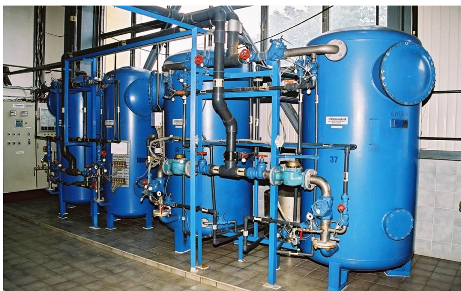
fot. 12 stacja uzdatniania wody dla potrzeb socjalno – bytowych i zapewnienia potrzeb bytowo – komunalnych
