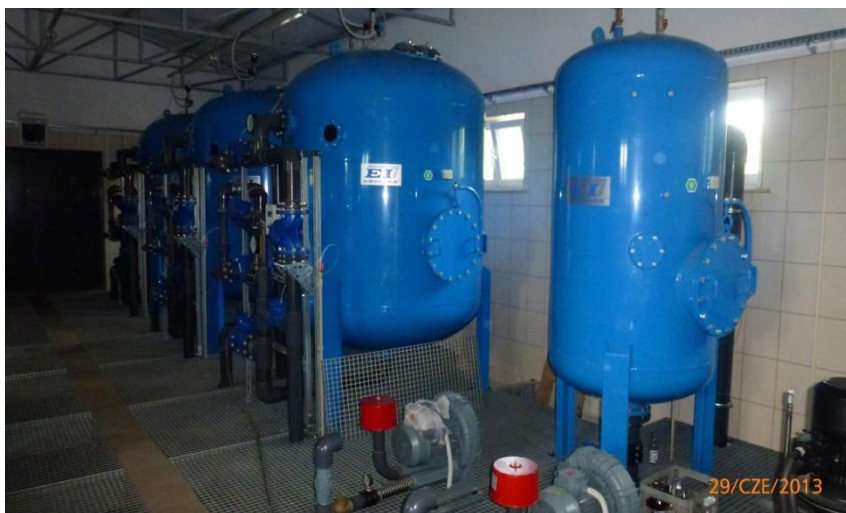
fot. 14 ujęcie i uzdatnianie wody zrealizowane w technologii filtracji dwustopniowej ciśnieniowej – widoczne zbiorniki wyrównawcze – zdolność produkcyjna 47m 3 /h
