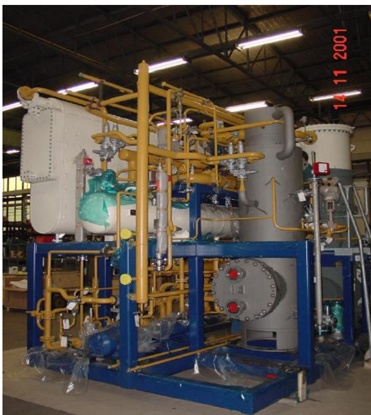
fot. 17 wysokowydajna i efektywna ekonomicznie ziębiarka absorpcyjna amoniakalna – zdjęcie wykonane dzięki uprzejmości Mattes AG – Niemcy
