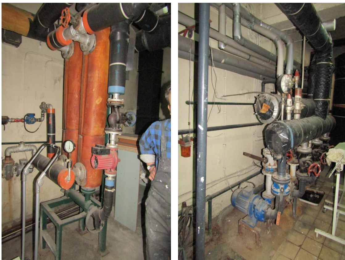
fot. 5 kolejny przykład bezwładnościowych systemów ciepłowniczych zaopatrzonych w ręczne układy sterowania i pompy wyeksploatowane starej generacji
